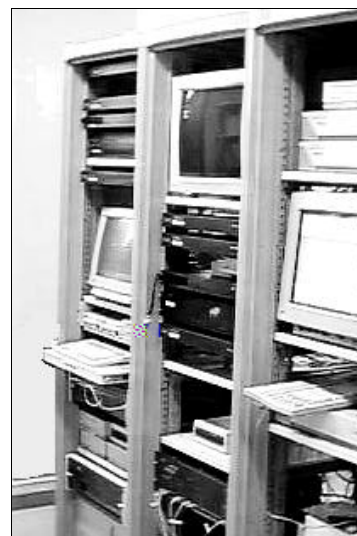
図 4. NOC 内部の機器収容ラック
